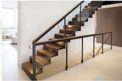
Merdiven korkuluğu ve küpeşte elemanları
